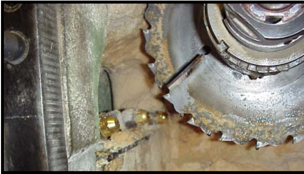
Sågklinga efter installation av NWC system
